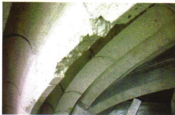
Afbrokkelende tufsteen in de luchtboog zuidgevel
